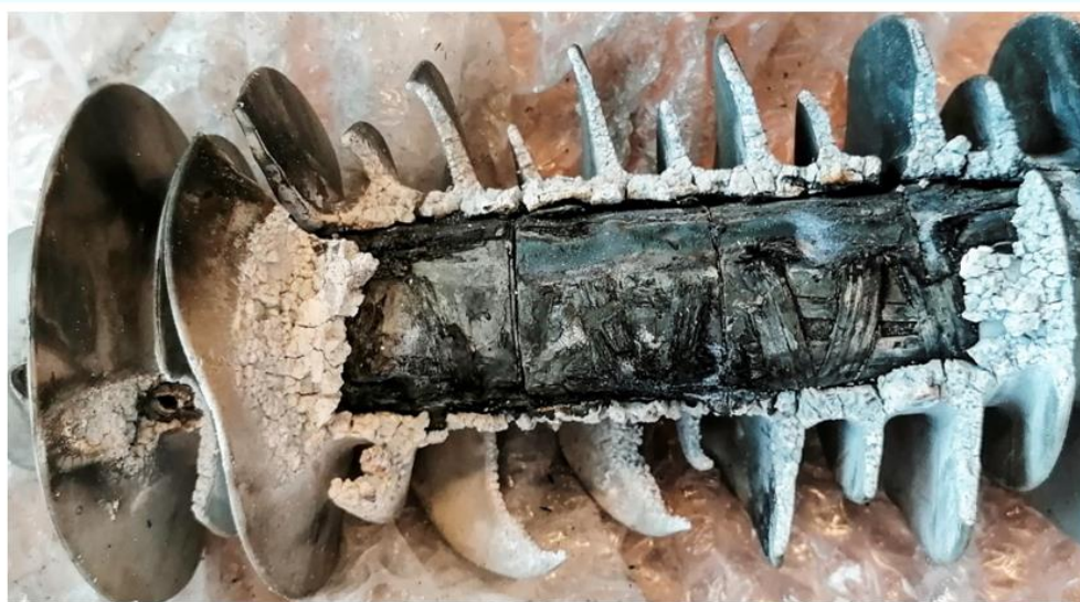
Uszkodzony ogranicznik – przyczyna: wada fabryczna
