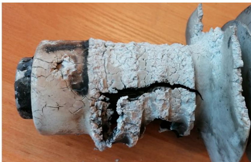
Uszkodzony ogranicznik – przyczyna: wada fabryczna
